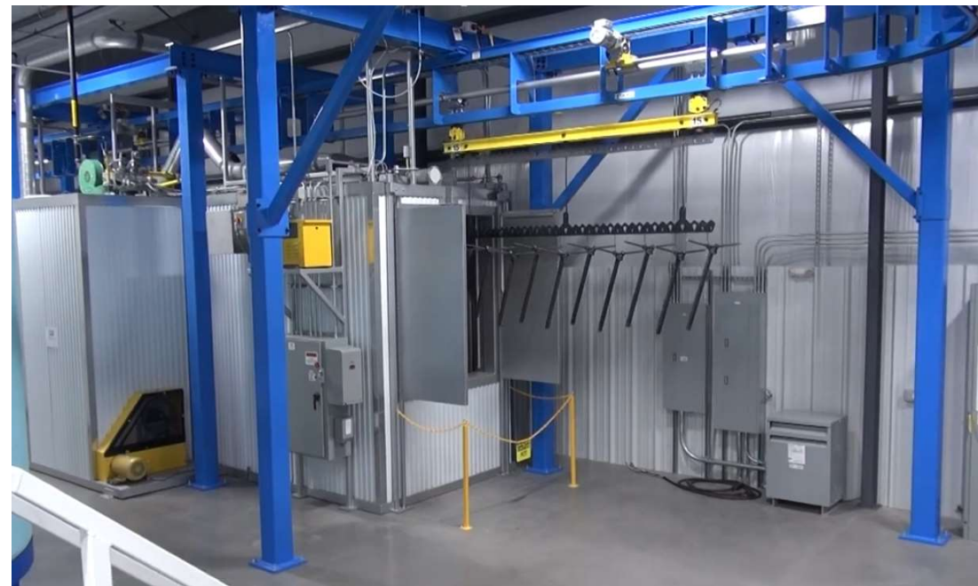
Zautomatyzowana lakiernia proszkowa.
